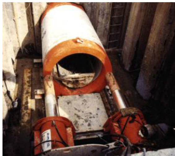
Figura 3 – Particolare martinetti idraulici
